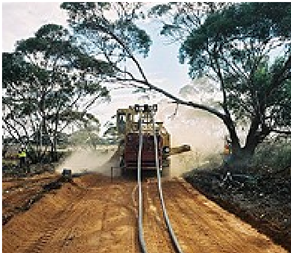
Bij het Murraylink project werd meer dan 3 km HVDC-kabel per dag aangelegd.
